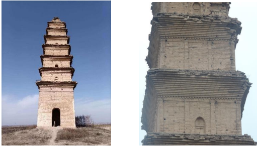
a 罗山寺塔 b 塔檐残损
