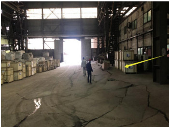
图 1 轨道基础东侧下沉
