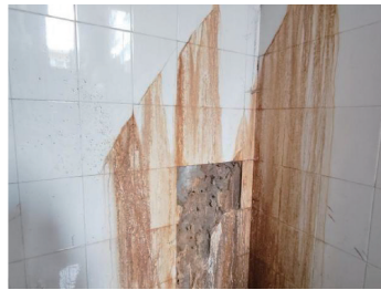
图 5 楼梯间外墙渗水
