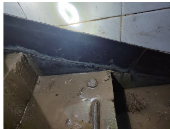
图 6 楼梯踏步渗水
