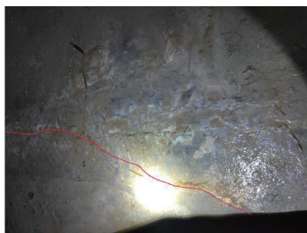
图 4 混凝土底板渗水
