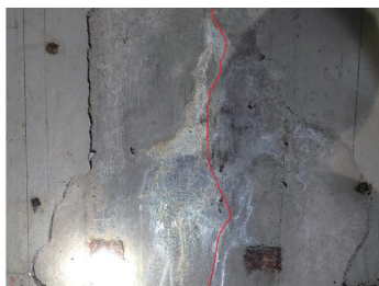
图 3 混凝土侧墙渗水
