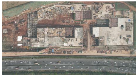
图1 成都市洗瓦堰再生水厂
