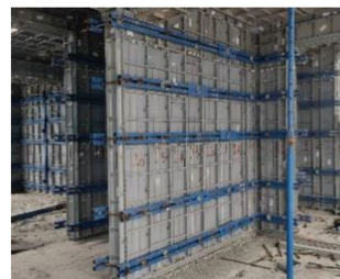
图1 模板支撑体系调整
