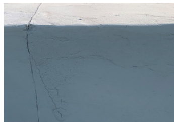
图3 砂浆修补出现裂纹
