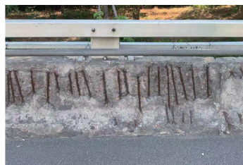
图2 防撞墙破损情况
