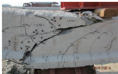
图4 未加固梁破坏状态
