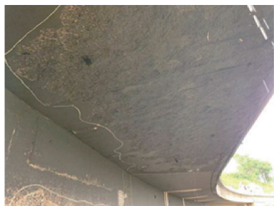
图 3 箱梁混凝土剥落
