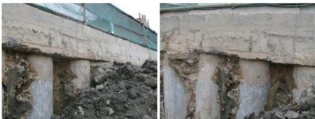
图1 盖板开裂 Fig. 1 Cover cracking
