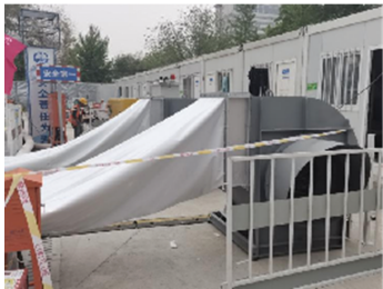
图 3 气膜风机系统 Fig.3 Air film fan system
